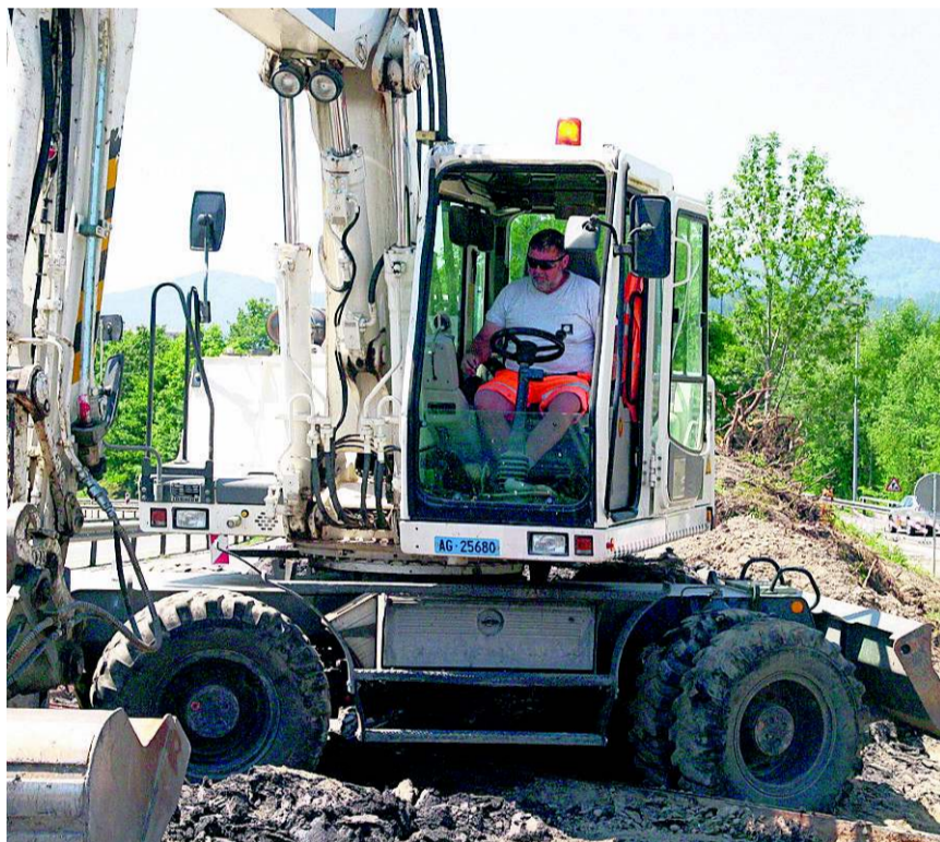
Im Bagger herrschen tropische Temperaturen. AHU
